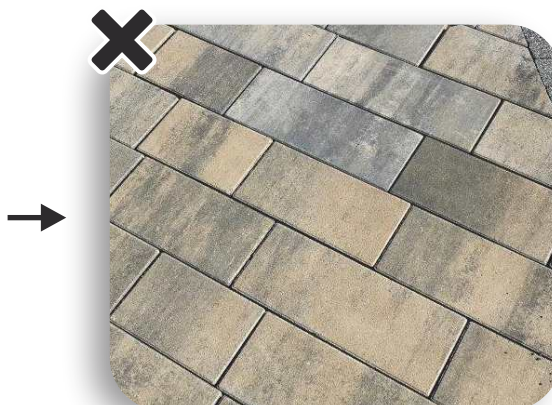
KOSTKA ŻÓŁKNIE Z POWODU ŹŁE WYKONANEJ PODBUDOWY
